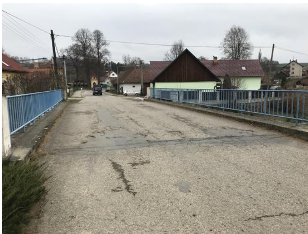
Obr. 45 - Závada na mostě v místní části Kletečná
